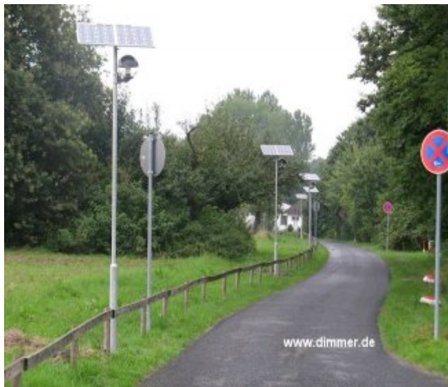
LED Solar-Straßenbeleuchtung in der Gemeinde Großkrotzenburg im Main-Kinzig-Kreis
